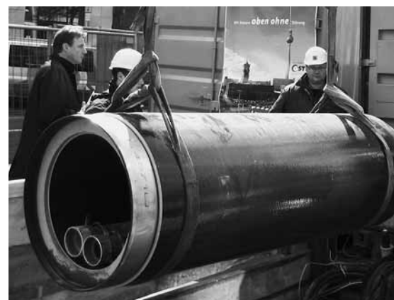
■ Im Rahmen ihrer Imagekampagne „ Wir bauen oben ohne Störung “ lud die GSTT zum Baustellenbesuch in die Potsdamer Straße ein.
